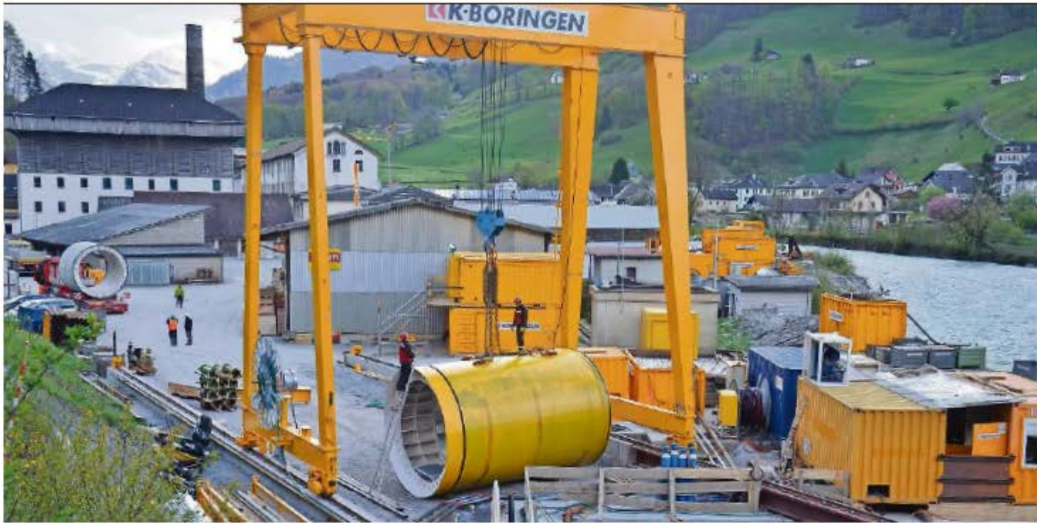
Aufgelaufen: Rohr um Rohr ist von der Kraftwerkbaustelle in Mitlödi her in den Berg gepresst worden – nun endet der Vortrieb von der «Doppelpower»-Talsette her.
