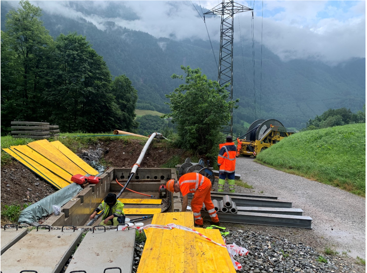
Bildlegende: Die neue, erdverlegte Hochspannungsleitung des Leitungsabschnitts Mitlödi bis Löntsch und weiter bis Netstal, ersetzt eine bisher über 23 Masten verlaufende 50-kV-Freileitung. (Bildquelle@snenergie.ch)
